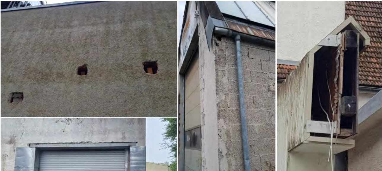
Abb. 10: Spalten und Höhlungen in der Außenfassade sowie Lüftungsrohre als Zugänge ins Gebäude
